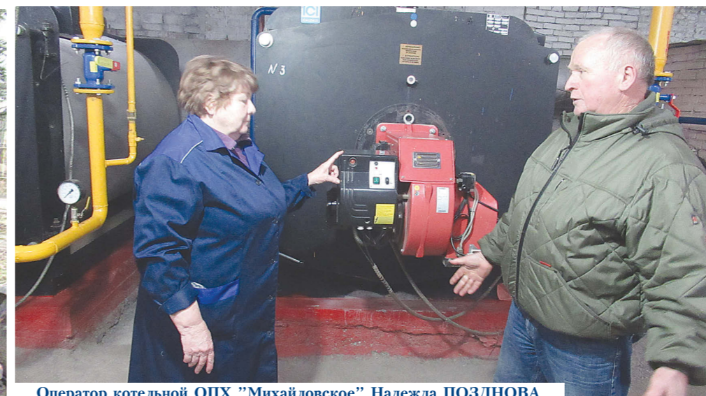
Оператор котельной ОПХ "Михайловское" Надежда ПОЗДНОВА
