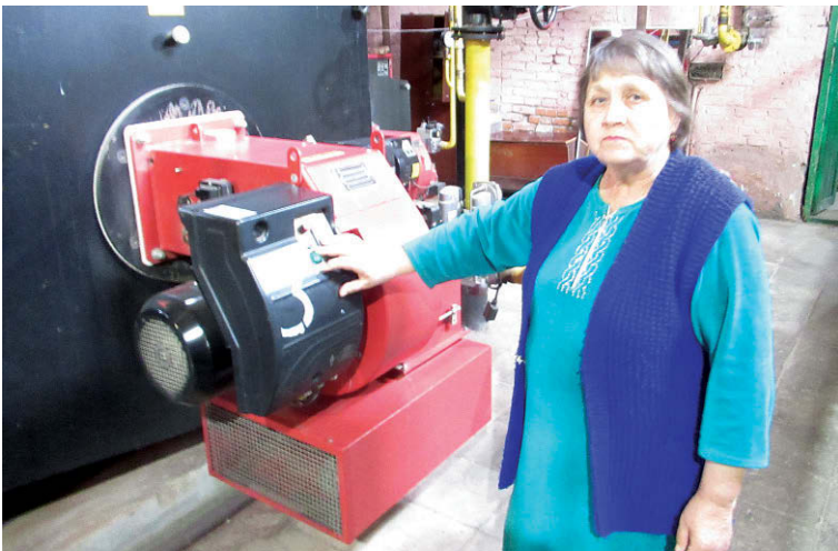
Оператор Зинаида АЛЕХИНА следит за работой котла
