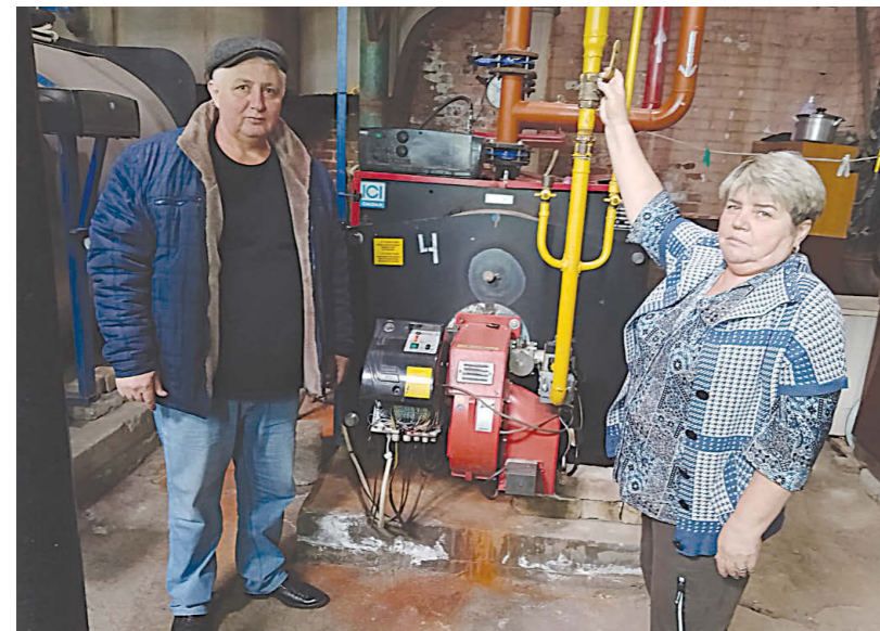
Начальник теплоучастка Артур ТЕДЕЕВ и оператор Светлана ХОРУНЖЕНКО проверяют работу котла
