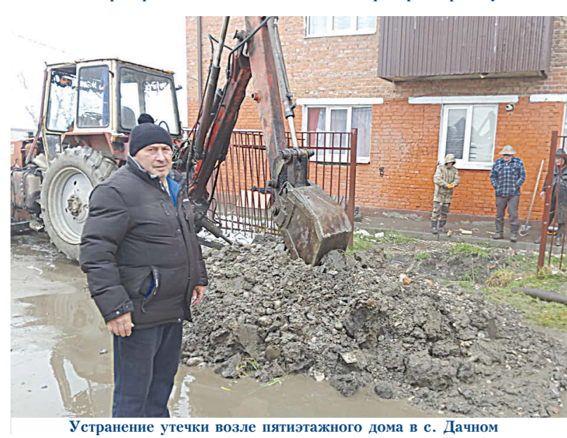
Устранение утечки возле пятиэтажного дома в с. Дачном
